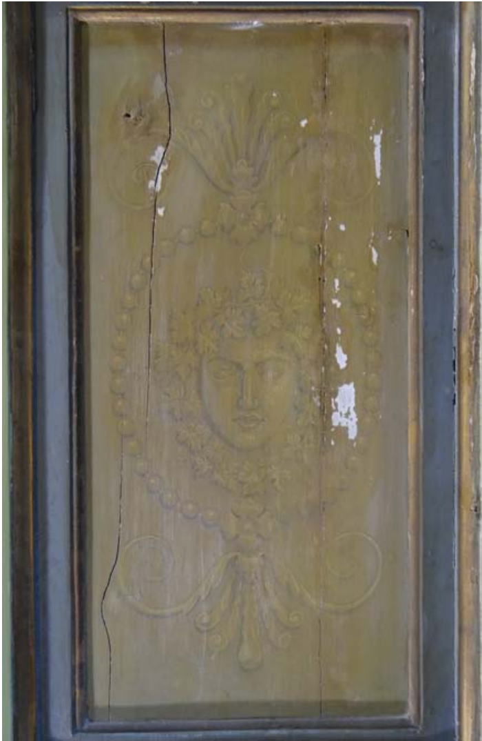
Particolare delle lesioni su un infisso in legno
