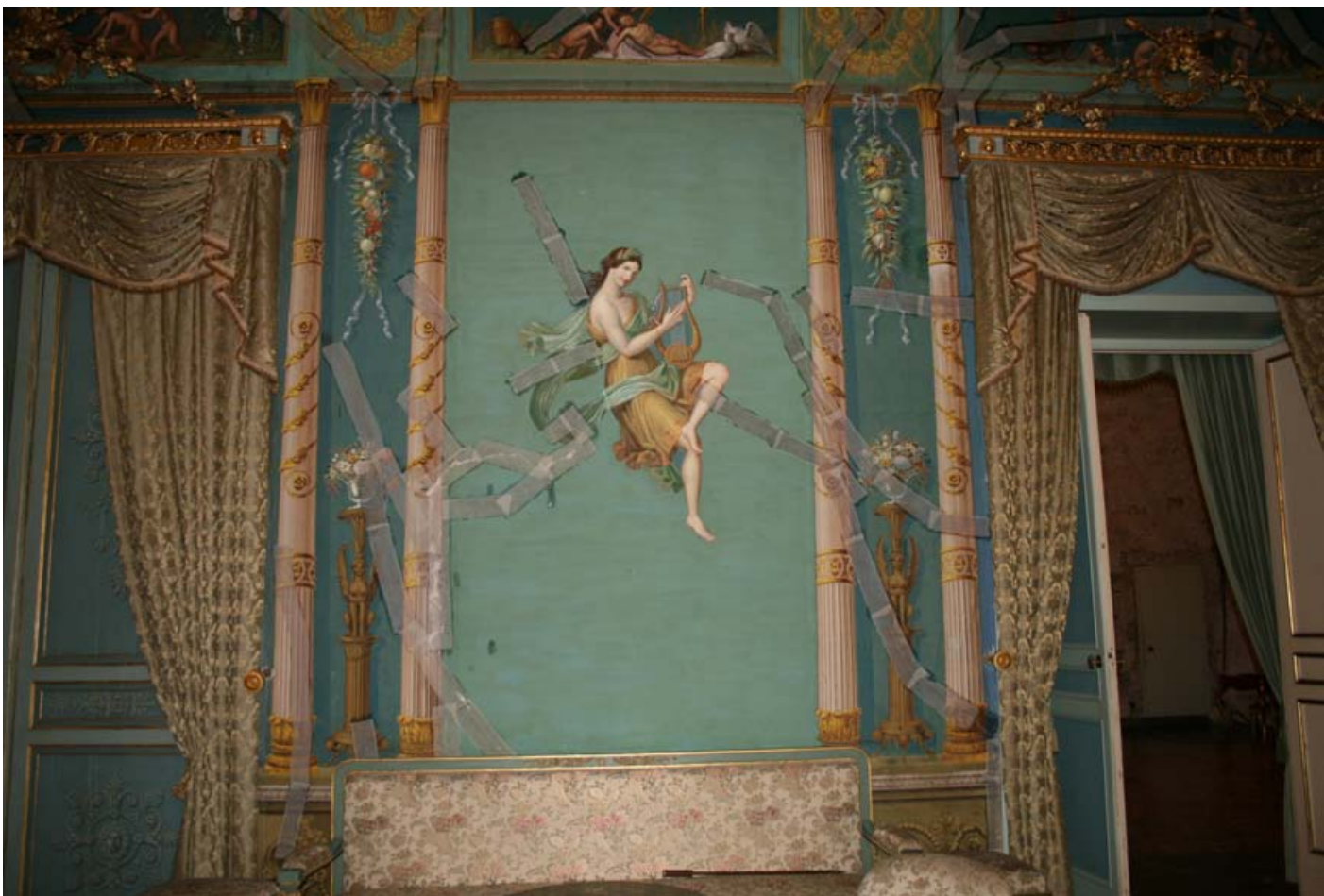
Pareti lesionate dal sisma
