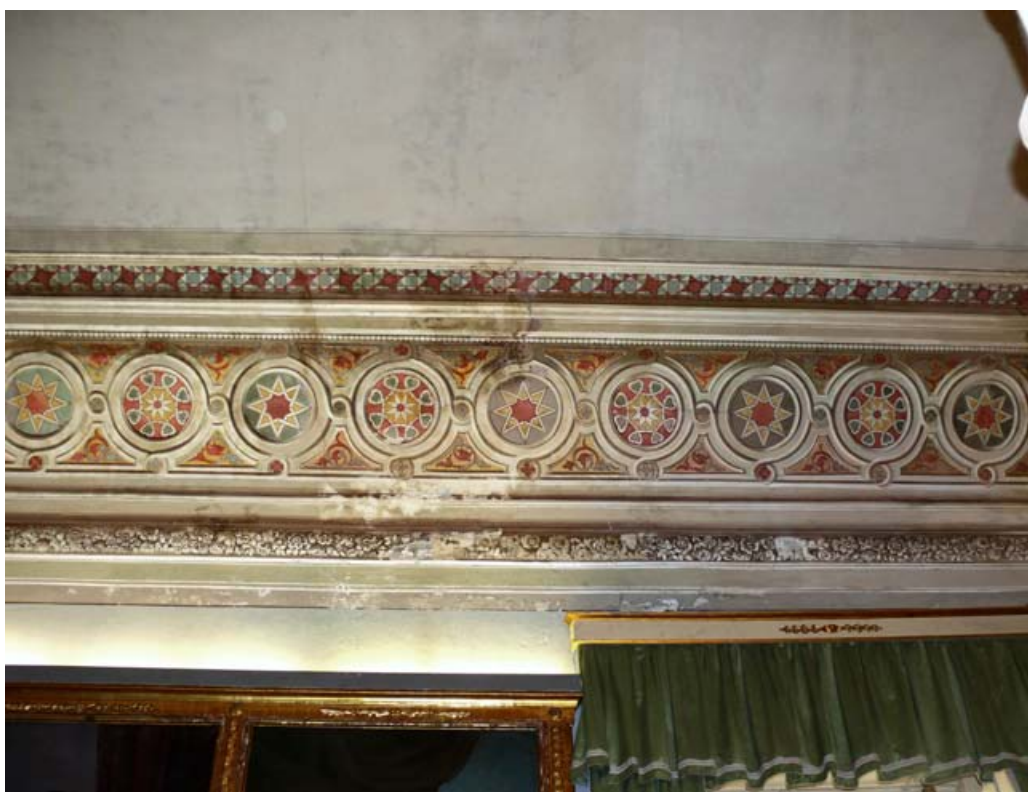
Particolare decoro con efflorescenze saline e macchie diffuse
