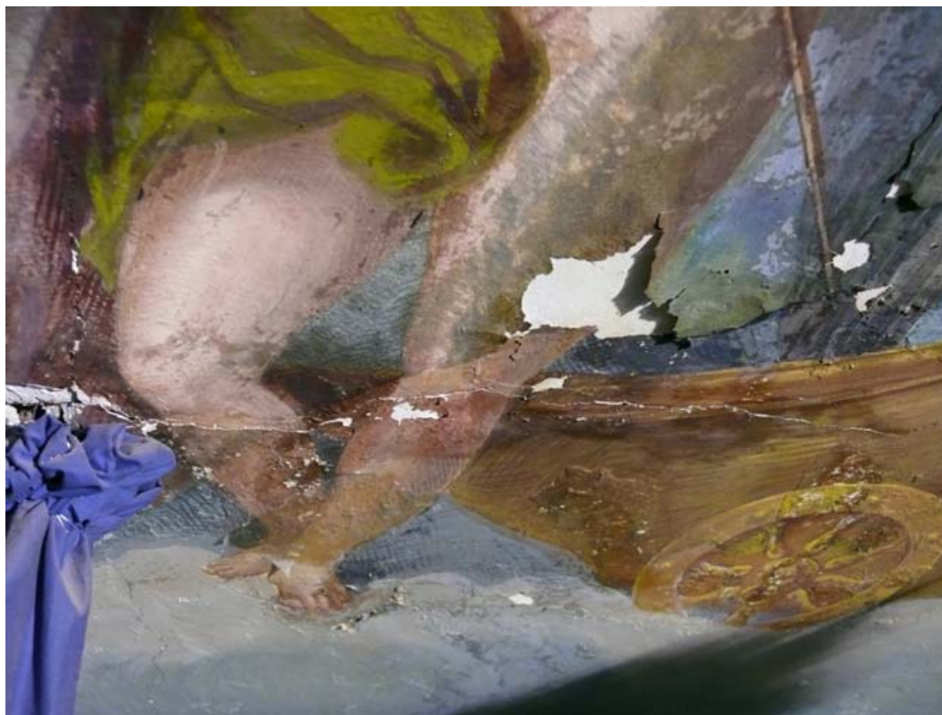
Particolare della volta con fenomeni di decoesione e disgregazione della pittura
