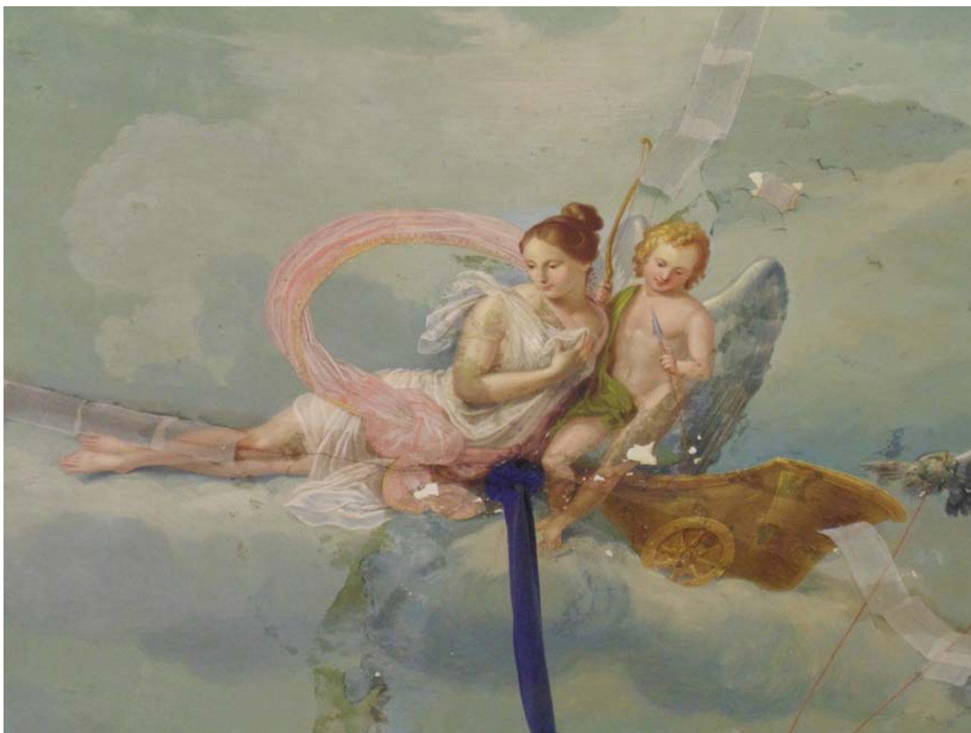
Particolare volta con fenomeni di distacco delle materie pittoriche
