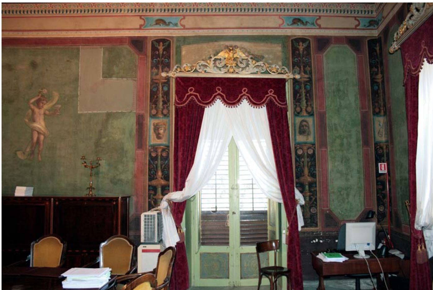
Parete con tassello di pittura di un precedente intervento
